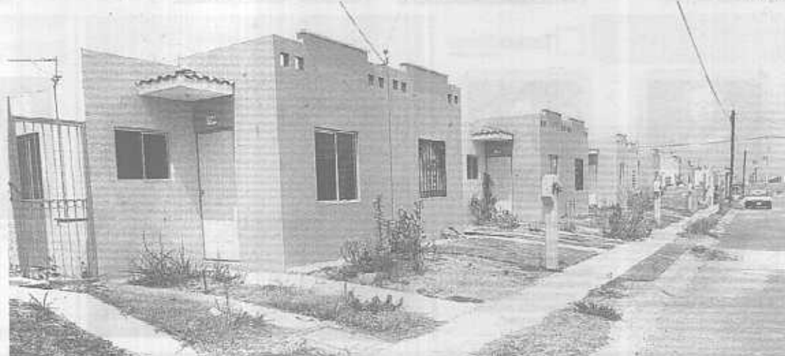
Santa Fe. El estado de las casas y sus deficiencias de estructura ha sido una de las quejas frecuentes
