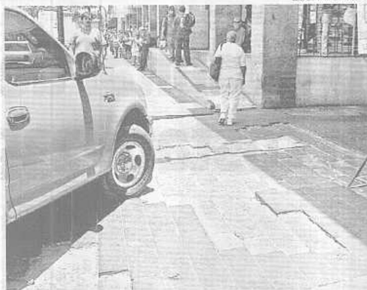
Adoquines levantados, parte de los desperfectos en la zona remodelada
