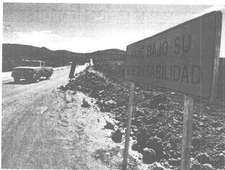
Los trabajos para ampliar la Carretera Tuxcueca-Mazamitla han dejado tramos de difícil circulación. Hay letreros que advierten de los riesgos.
