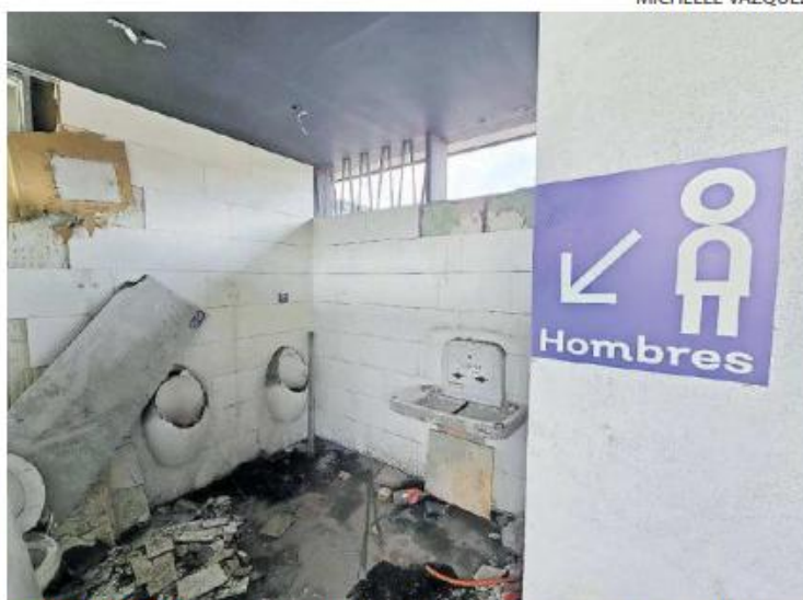
ABANDONADOS. Los baños instalados en los módulos revisados se encuentran en condiciones deplorables.
