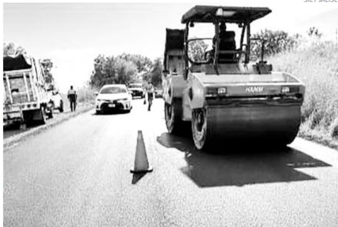
Ameca-Mascota tiene el mayor deterioro de la red carretera en la entidad.
