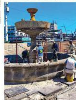
La restauración de elementos de cantera en la fuente y arcadas se contempla en el proyecto.
