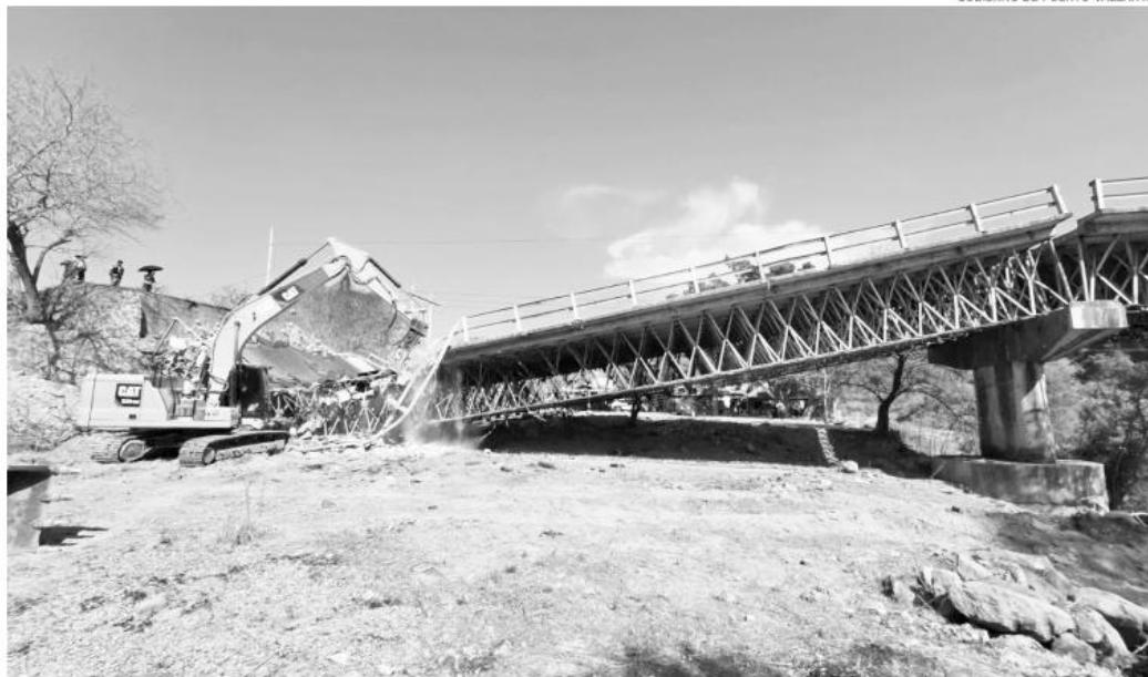
El puente sufrió daños estructurales irreversibles debido a las explosiones del 22 de febrero.
