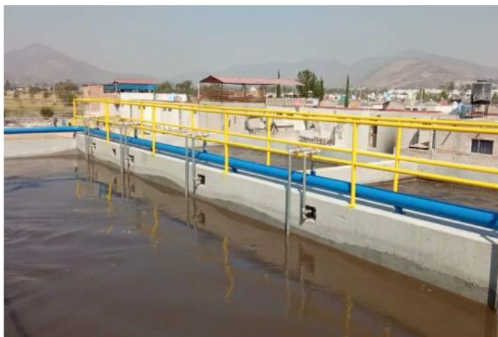
Esta planta trata el agua sucia de al menos 5 mil viviendas en la colonia La Noria. ESPECIAL
