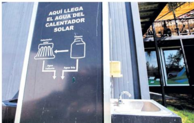
Calentador conectado a las cisternas de captación de agua (Edgar Campechano/UdeG)
