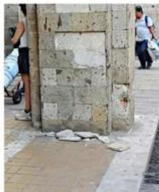
■ A algunos pilares de Paseo Degollado le faltan las losas.
