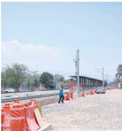
LO ÚLTIMO QUE SE SABE. Las obras de la línea 4 tienen un avance general de 89 por ciento, según la administración estatal.
