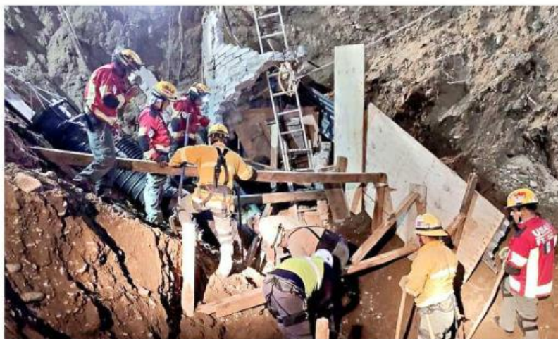
■ El accidente ocurrió en una zona conocida como El Aserradero.
