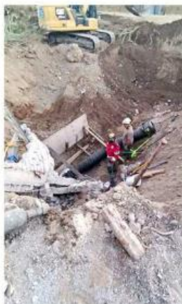
■ Los dos hombres quedaron atrapados por el derrumbe.
