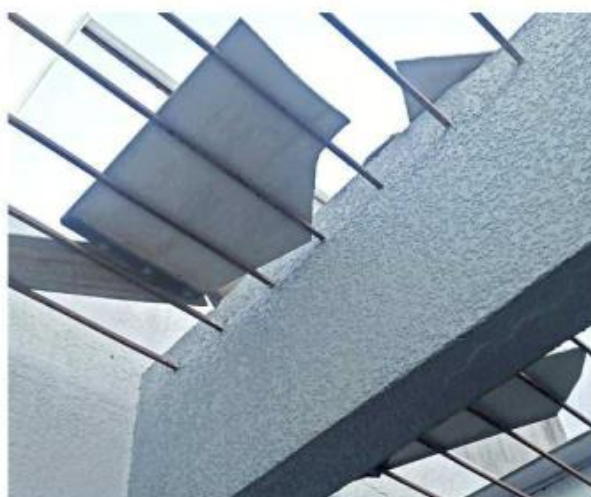
La persona tuvo que arreglar por su cuenta los daños al tragaluz y un muro de su casa.
