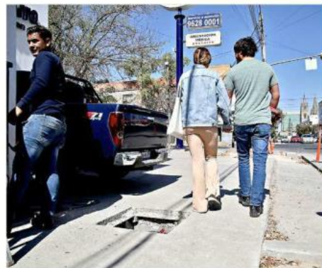
■ En las obras de renovación de banquetas hay registros que no tienen tapa ni señalamientos.
