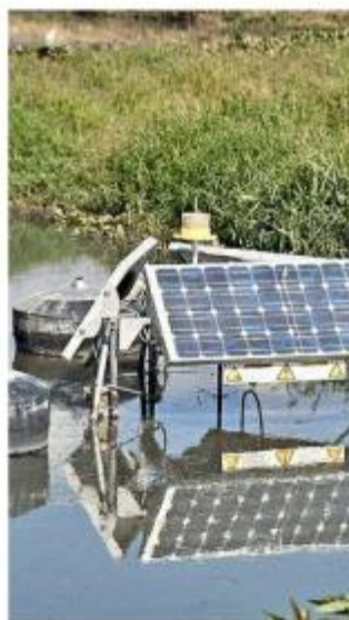
■ Son ocho los aireadores que se instalaron en la Laguna de Cajititlán.
