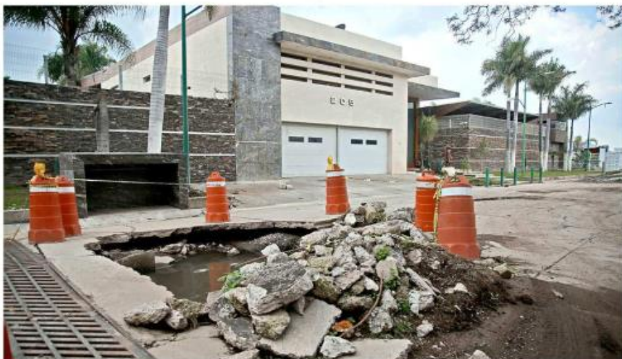
En la zona, el vecino habría construido un taponamiento que generaba inundaciones en otras casas vecinas.
