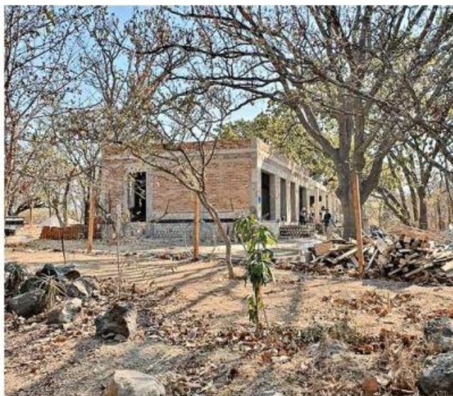
■ Esta es la construcción que denuncian vecinos, la cual está dentro del Área Natural Protegida.
