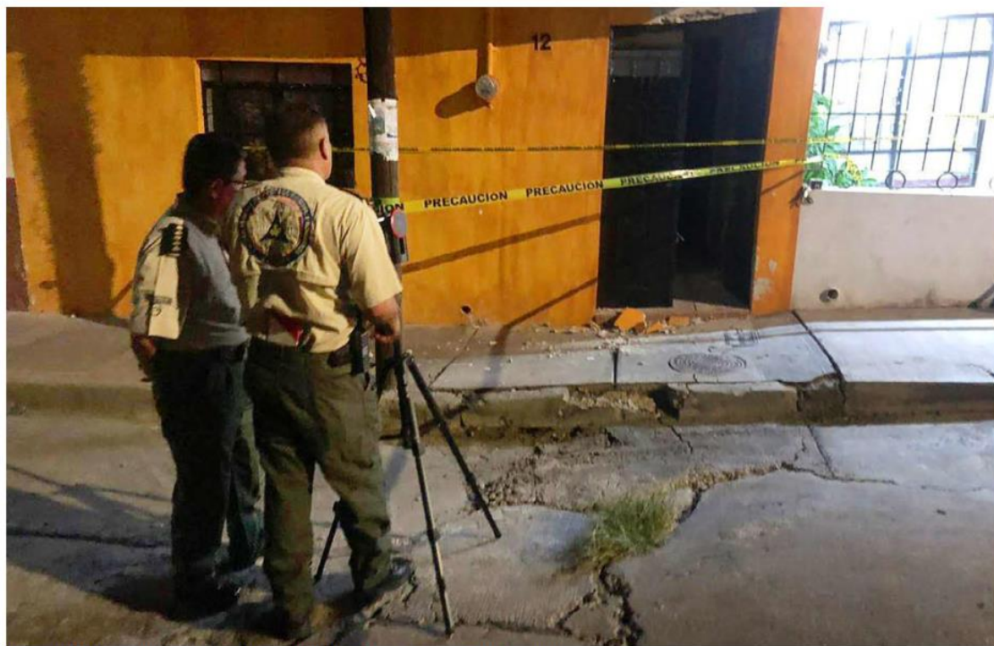
Personal de Protección Civil estatal evalúa los daños en los inmuebles. ESPECIAL
