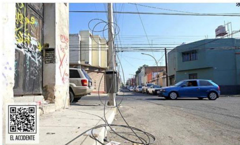
Los cables colgando, en varias partes de la Metrópoli, han causado accidentes y daños.
