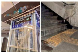
Estaciones de la Línea 2, como Tetlán, muestran la falta de mantenimiento en diversos accesos.
