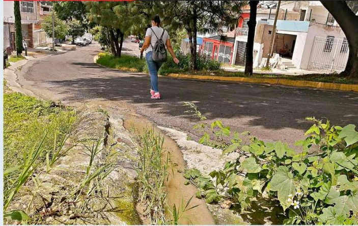
■ “Río” de aguas negras en la Calle Paseo de los Patios, a la altura de Paseo del Refugio, en Balcones de Santa María, en Tlaquepaque.
