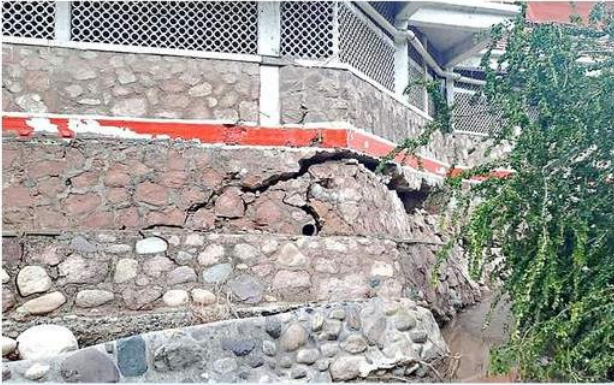
El Mercado Municipal de Puerto Vallarta presenta este daño, luego de desbordarse los ríos Cuale y Pitillal.
