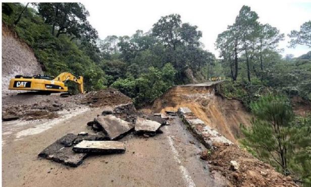
El derrumbe ocurría a la altura del poblado Piedra Ancha. ESPECIAL
