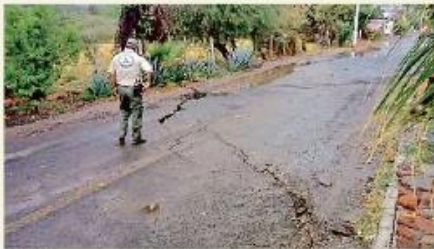
■ El 10 de mayo surgió la grieta la carretera Sayula-Usmajac.
