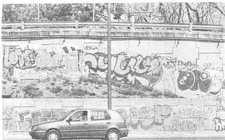
No importa que sea una barda o un paso a desnivel, el graffiti les llega. Así se observan las "firmas" colocadas en Lázaro Cárdenas y Carretera a Chapala.
