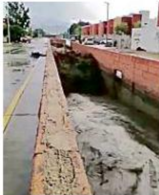
■ El ancho del Arroyo La Culebra se ha reducido por viviendas construidas.
