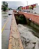
El ancho del Arroyo La Culebra se ha reducido por viviendas construidas.
