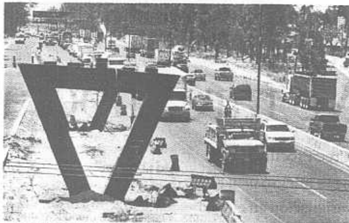
➤ Las obras en el Nudo de Periférico y Tutelar están abandonadas debido a una orden judicial; debido a esto, la Sedeur no puede construir nada.
