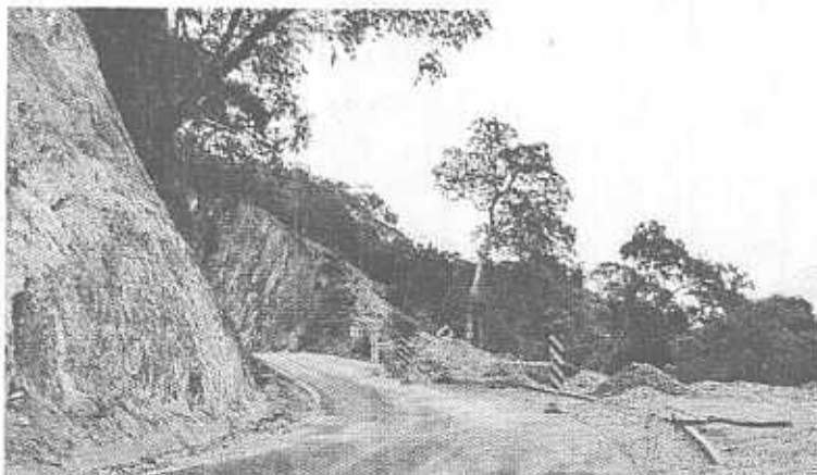
► De los 60 derrumbes en la Carretera Mascota-Las Palmas, siete obstruyeron algunos carriles de la vía, según informes oficiales.
