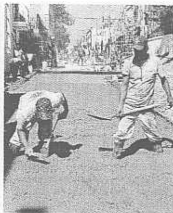
► Las obras en el Centro se verían beneficiadas con el proyecto de alumbrado.
