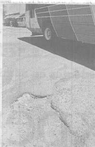
➤ Los agujeros provocan daños a los vehículos y caos vial.
