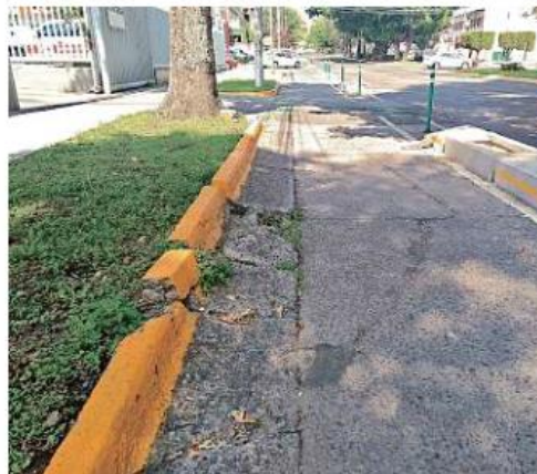
Las raíces de los árboles de las banquetas han levantado el pavimento, generando “topes” en la biciesenda.
